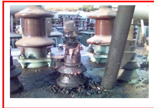
Figure II.2- Défaut suite au mauvais serrage sur borne BT
