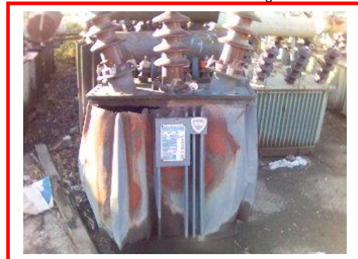
Figure II.3- Défaut à cause d'une foudre
