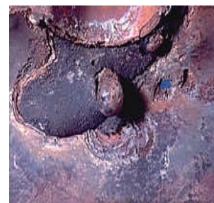
Corrosion galvanique au niveau d'une zone de brasage entre la brasure Cu-P et le tube en cuivre
