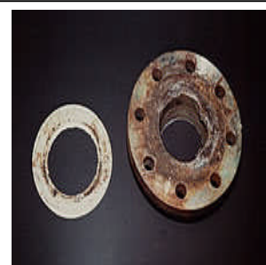
Corrosion cavernueuse d'un acier allié sous un joint
