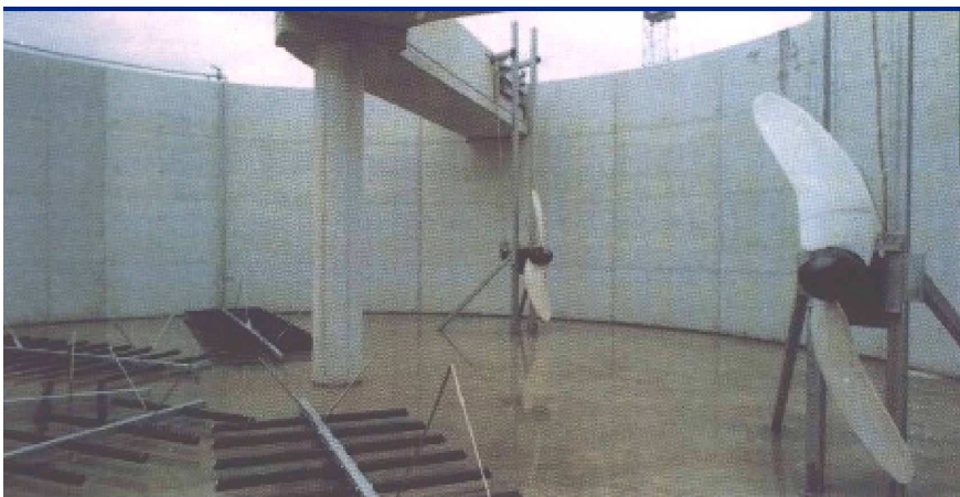
Photo 5 : Chenal d'aération - Insufflation d'air + agitation
