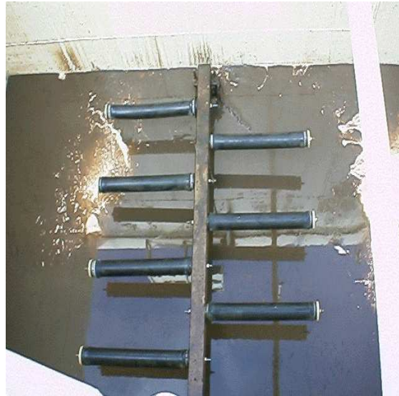
Photo 4 : Rampes immergées de Diffuseurs fines bulles
