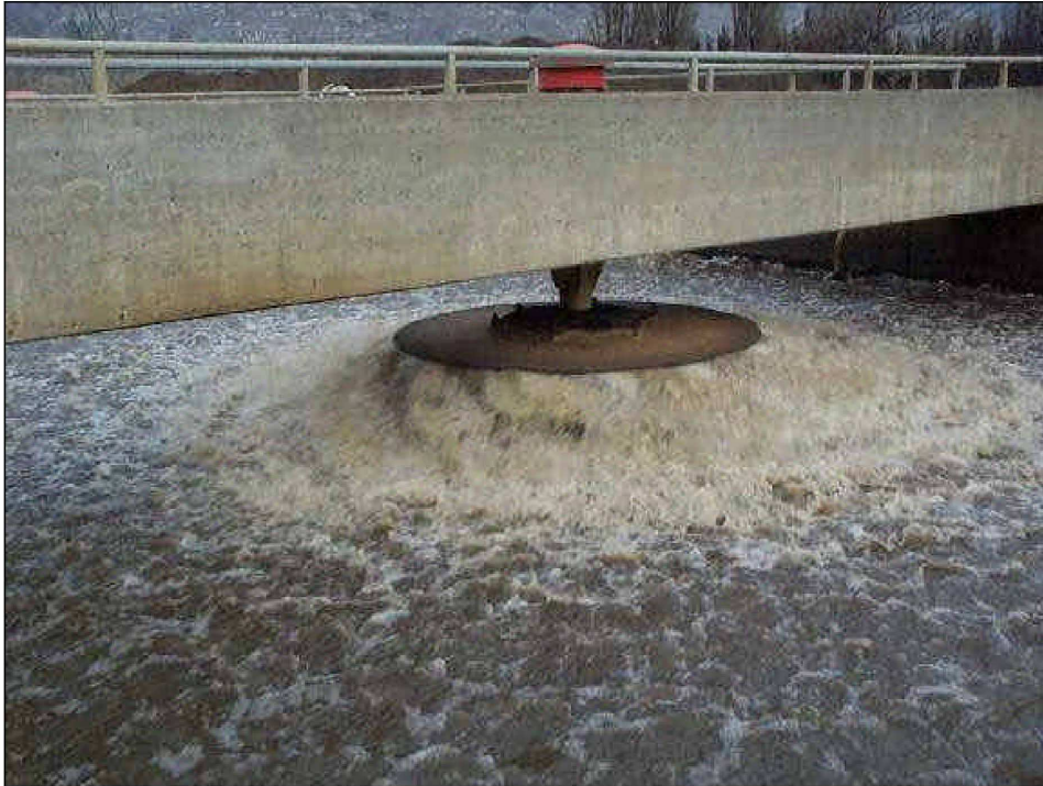
Photo 01 : Turbine de surface à vitesse lente (immersion insuffisante)
