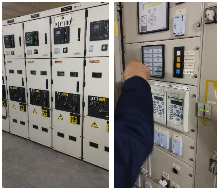
Figure I-6 : Cellules et l'armoire de protection
