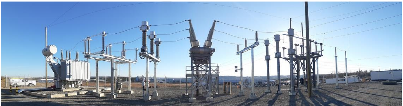
Figure I-4: Equipement de post électrique
