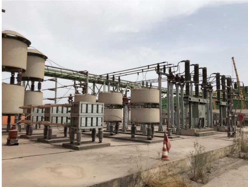
Figure I-5 : Sous station électrique
