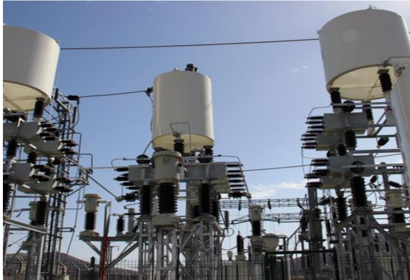
Fig (I.3) : photo réel de SVC
