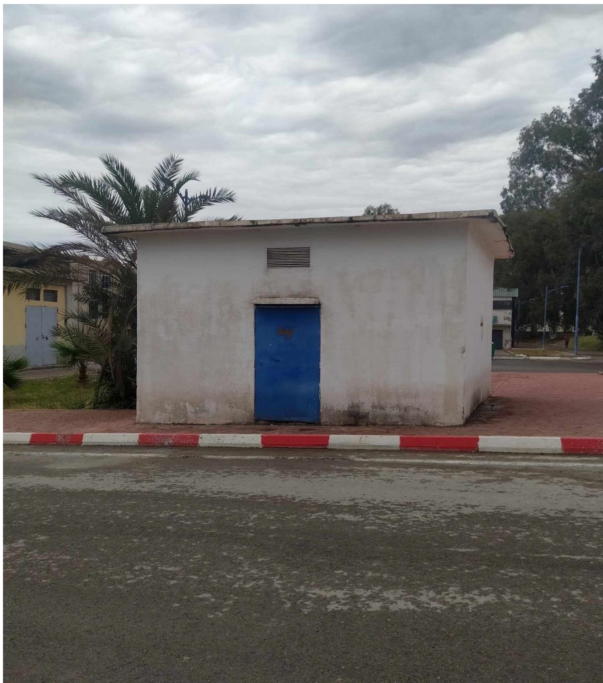
Figure II. 2: Photo du poste de l'extérieur, situé à l'université sidi Ammar, Annaba.
