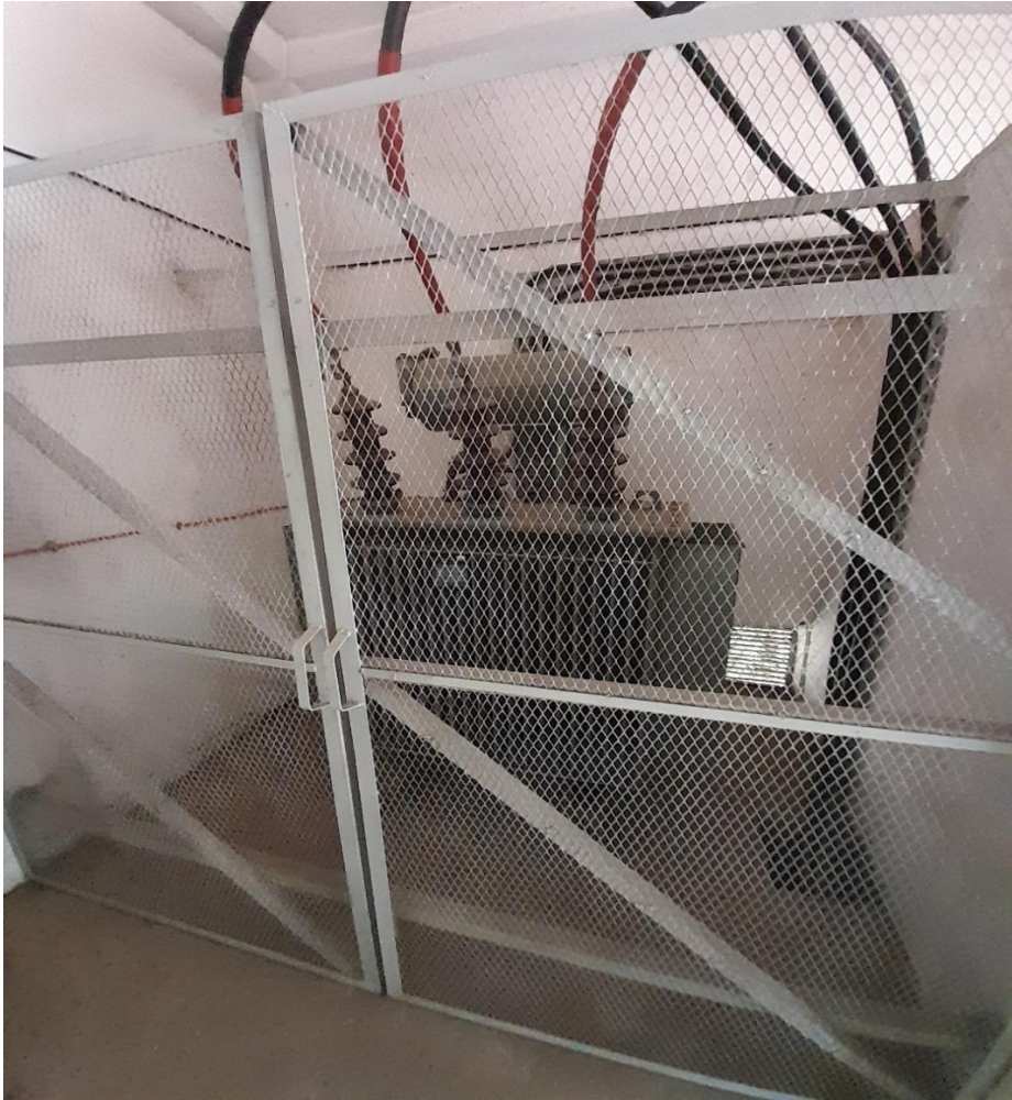
Figure II. 3: Photo du poste à l'intérieur
