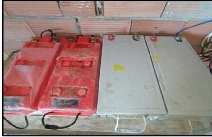
Figure 37: Les batteries solaires sont connectées
