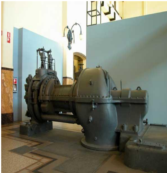
Figure 6: Turbine à vapeur industrielle.
