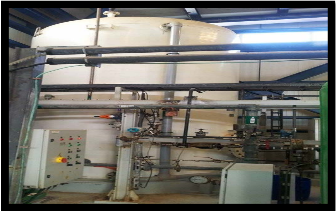
Fig 1.20 : production d'eau potable
