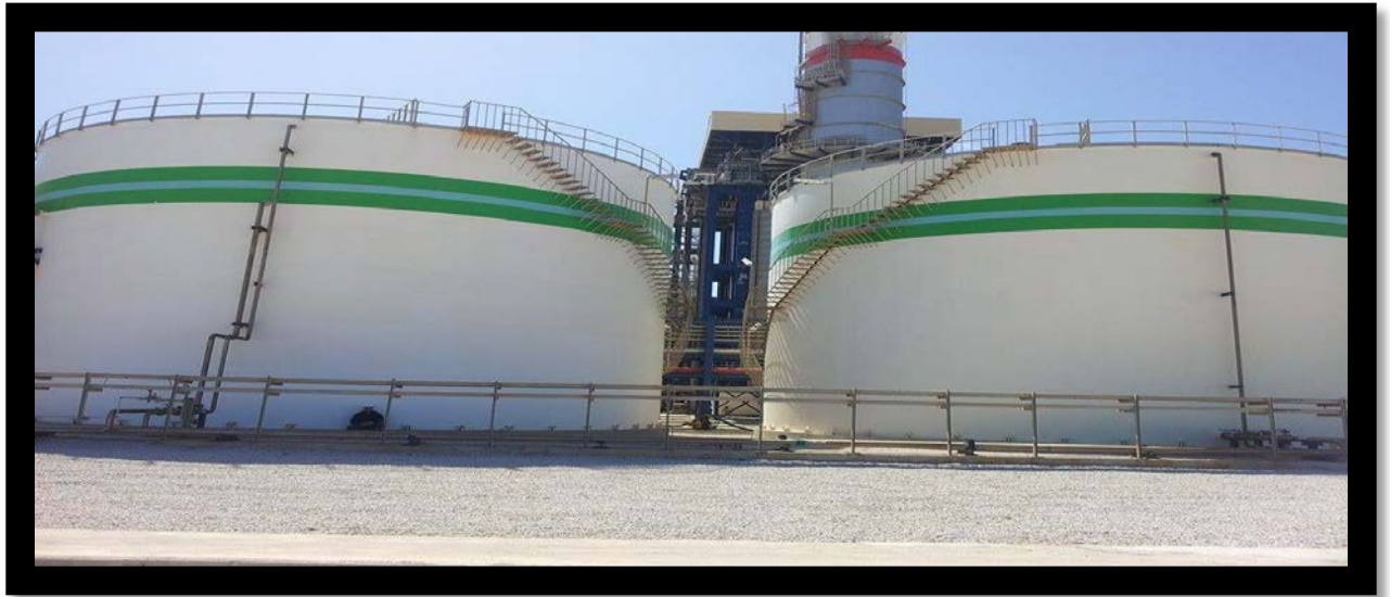
Fig 2.8: Réservoirs eau dessalée
