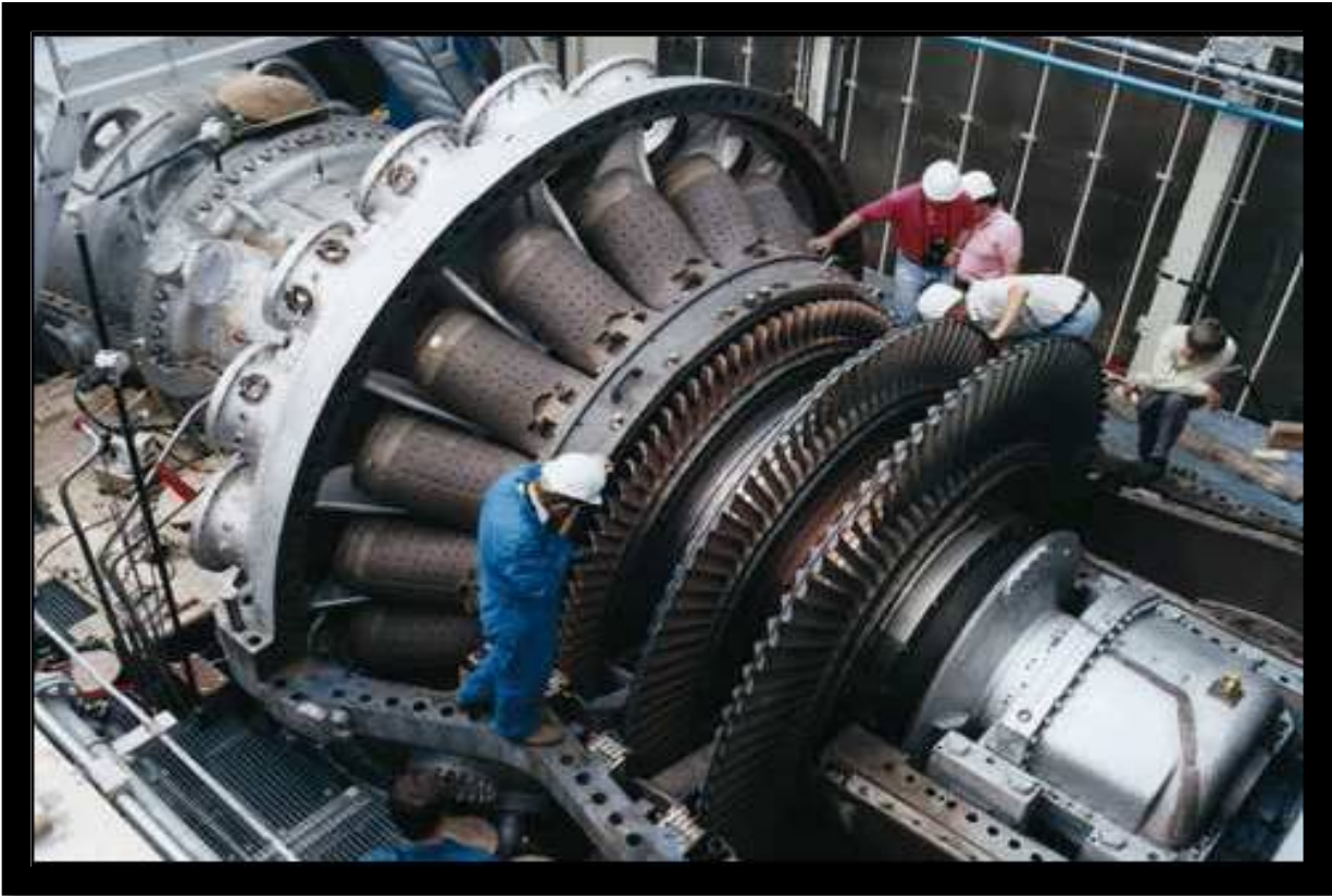
Fig 1.5 : turbine a gaz
