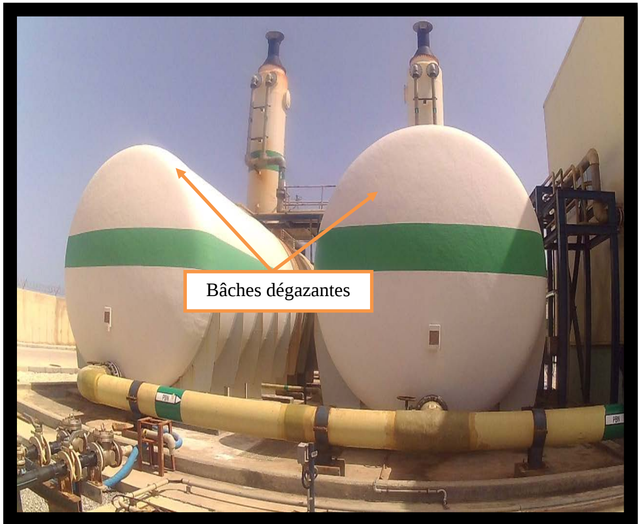
Fig 1.15-D : bâches dégazant et stockage javel
