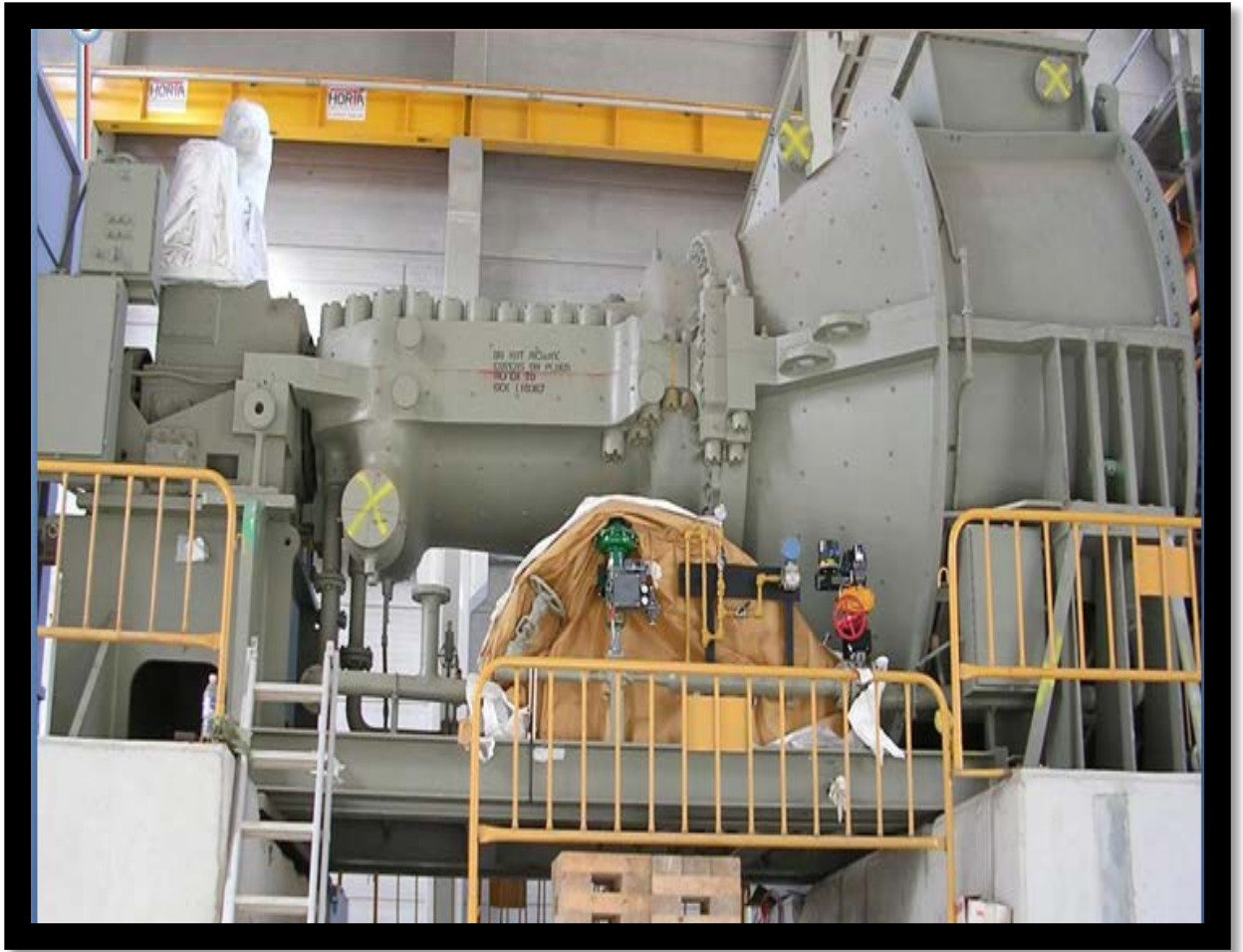
Fig 1.9 : turbine a vapeur
