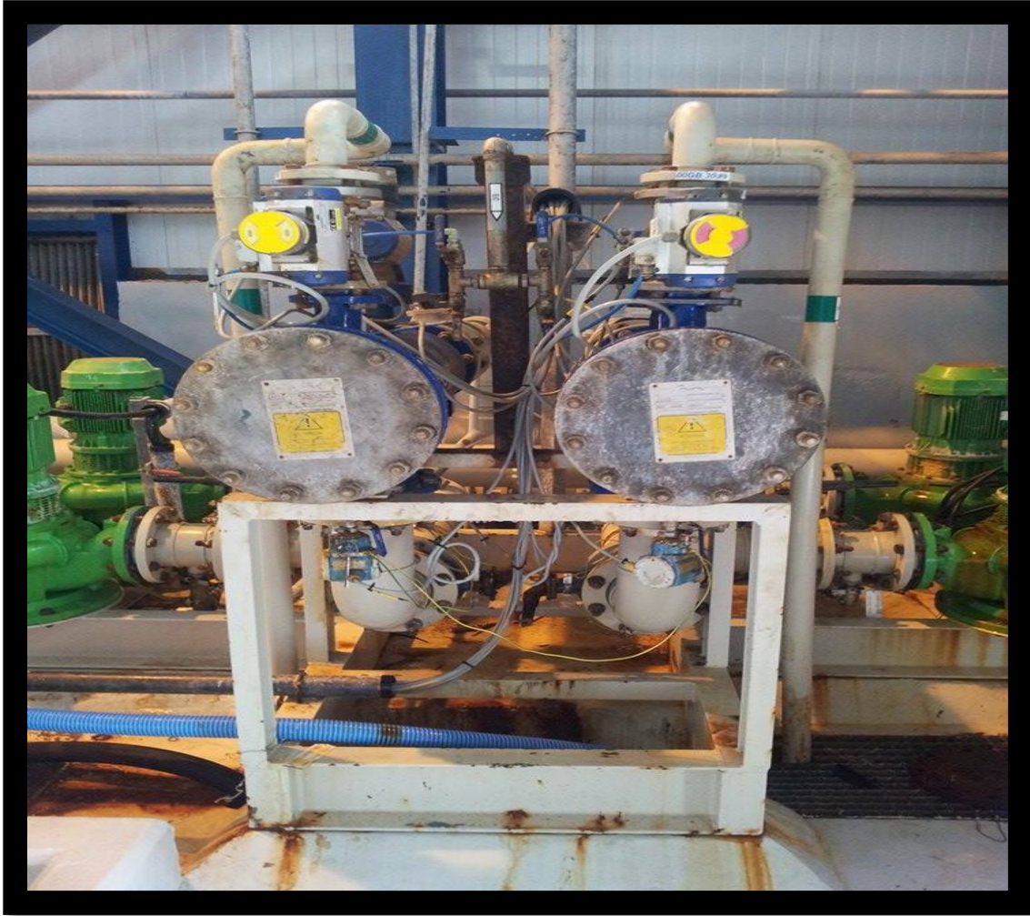
Fig 2.6 : Deux filtres autonettoyants à l'entrée du poste de dessalement
