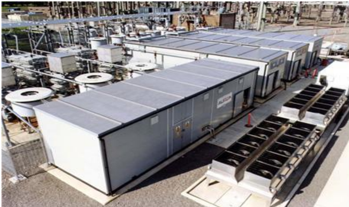
Figure I.7. Compensateur synchrone statique (STATCOM)
