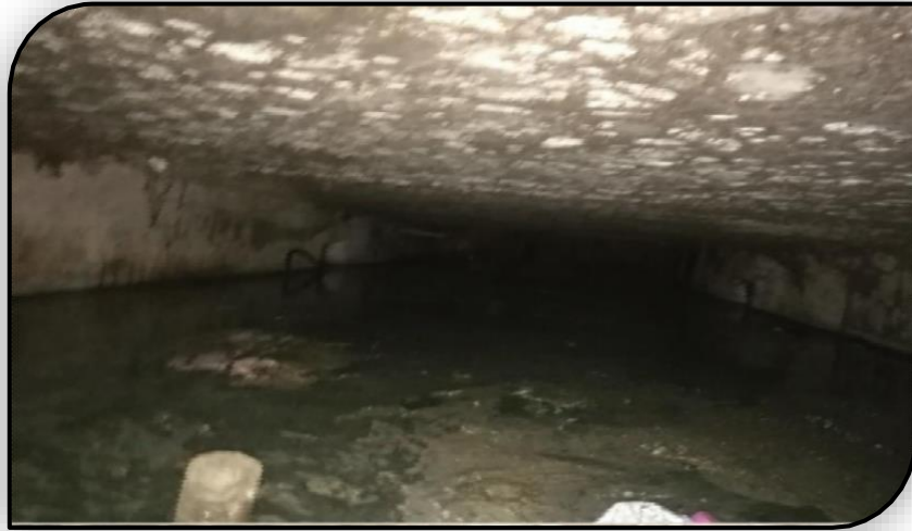
Figure 4. Vide sanitaire dans la cité des 920 logements, Sidi Amar (Photo personnelle).
