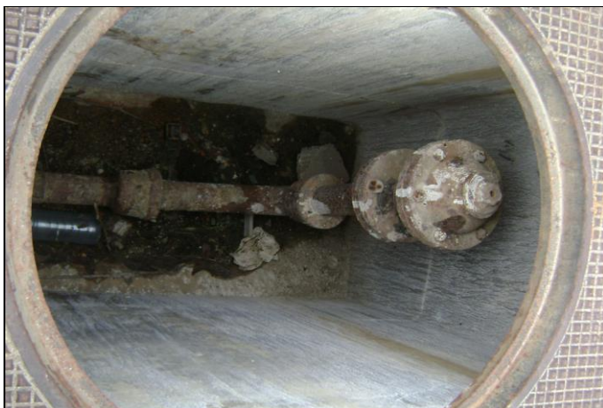
Photo 3.4 : Signe de corrosion sur ventouses.
