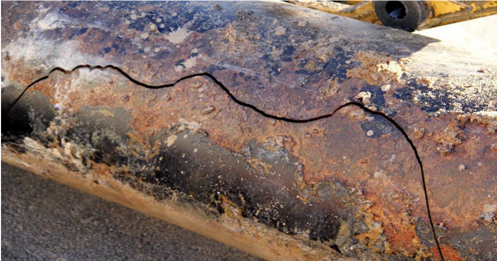
Figure I.6. Rupture longitudinale d'une conduite en fonte
