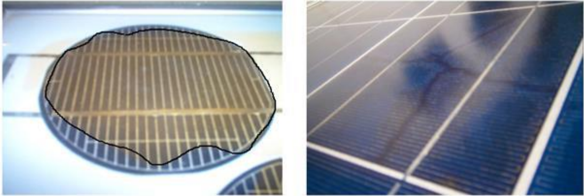
Fig. IV.4. Modules photovoltaïques avec des cellules décolorées
