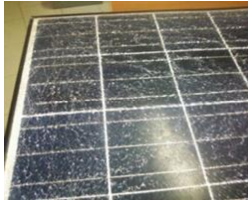
Fig. IV.5. Module photovoltaïque présentant des bris de verre
