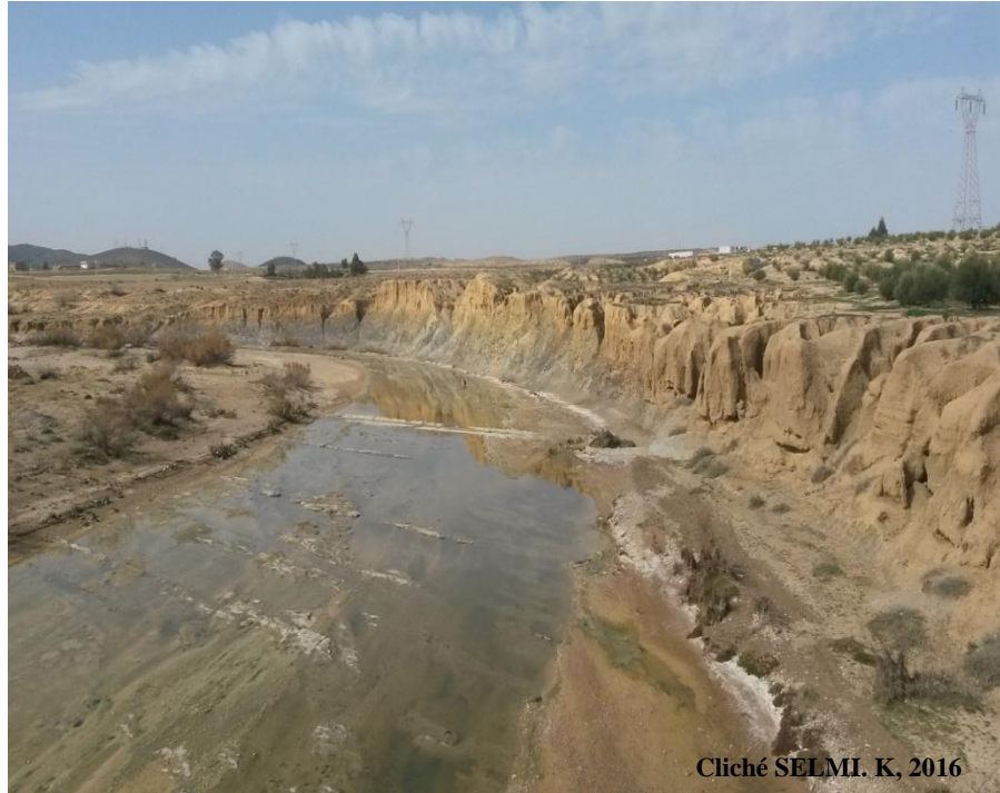
Photo 1. Forte érosion sous forme de sapement de berge à l'Oued Mellègue.
