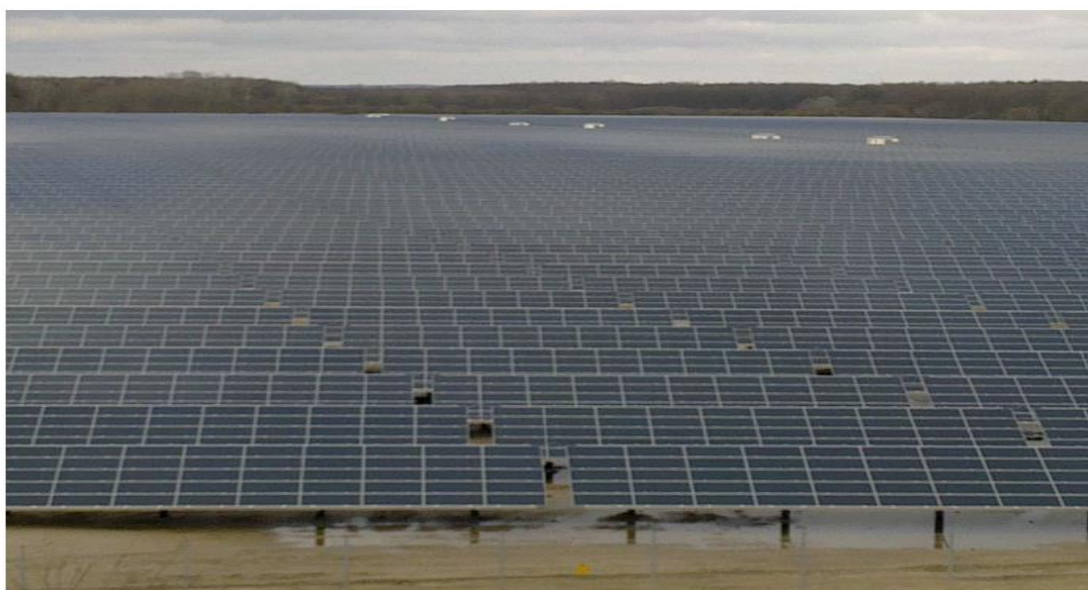
Figure 1. 5 : Centrale photovoltaïque à grande échelle pour services publics [18]
