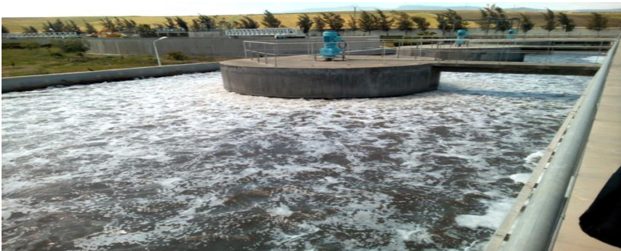
Figure. 63: Bassin d'aération. (STEP Guelma 2016)
