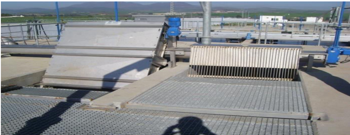
Figure. 60: Entrée de la STEP de Guelma(Dégrillage).
