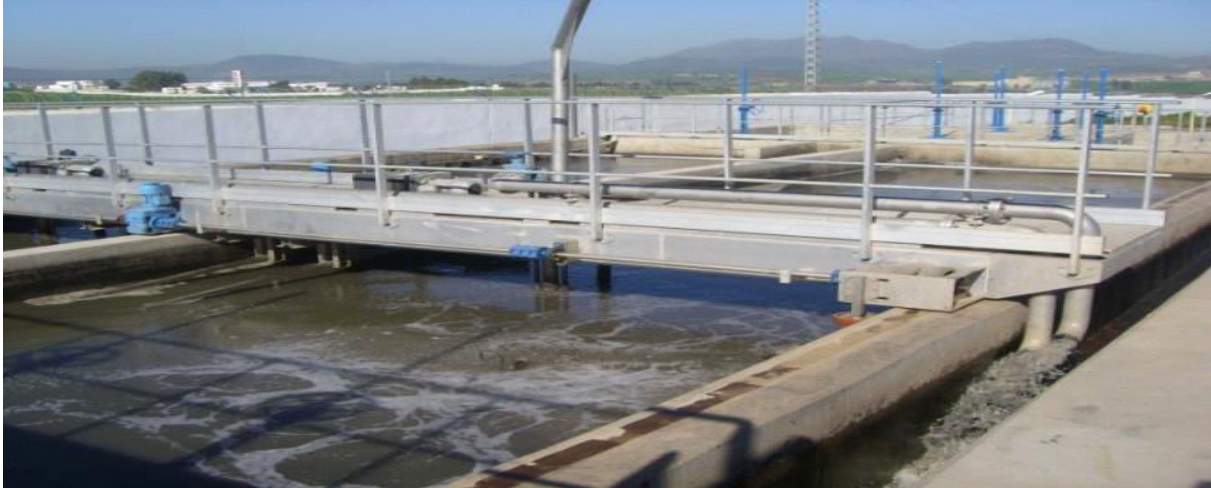
Figure.61 : Entrée de la STEP de Guelma (dégraissage-déshuilage).
