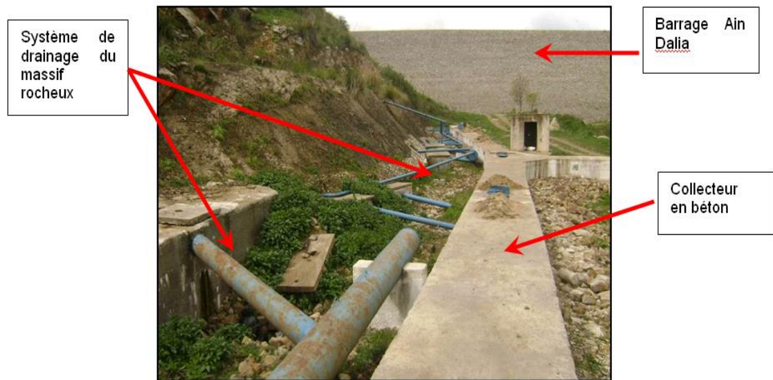
Photo I. 2 : Système de captage des sources d'Ain Dalia.
