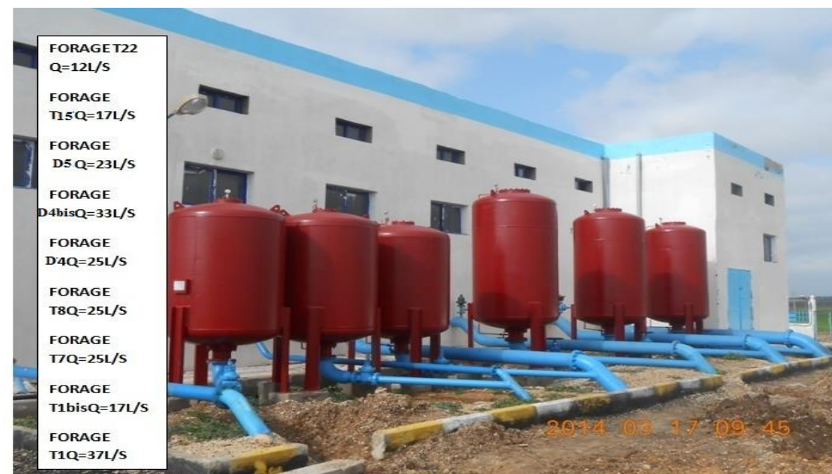
Photo IV.6 : Station de pompage Boumaaraf et ses équipements
