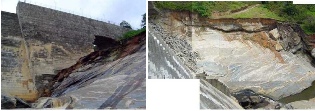
Figure 10-1 : La surface de glissement rive droite (Berbosa et al, 2004)
