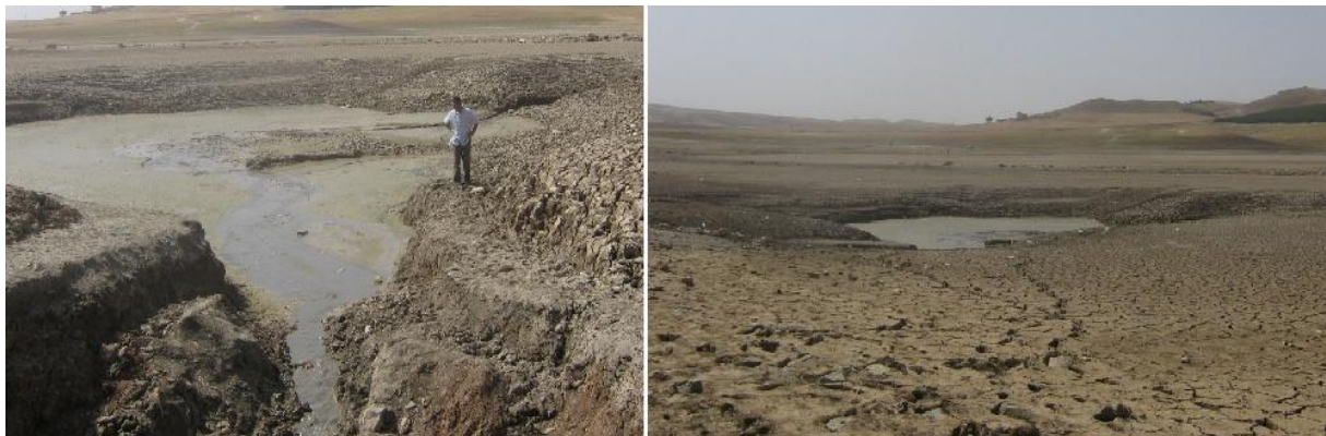
Figure 5-3 : La fuite du barrage sur la rive droit en 2003
