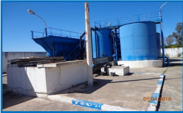
Station d'épuration (STEP) d'El Gantra El Hamra.
