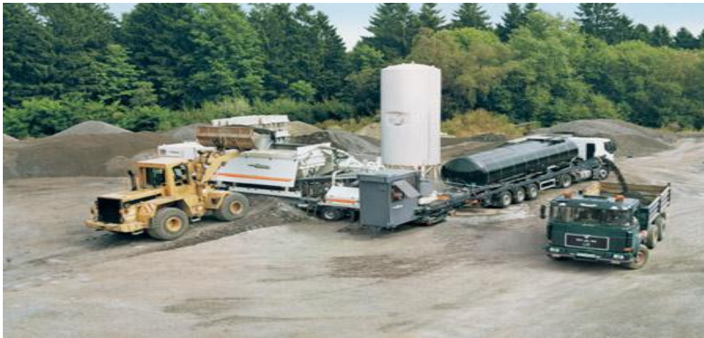
Fig.1.31: Centrale d'enrobage à froid ultramobile
