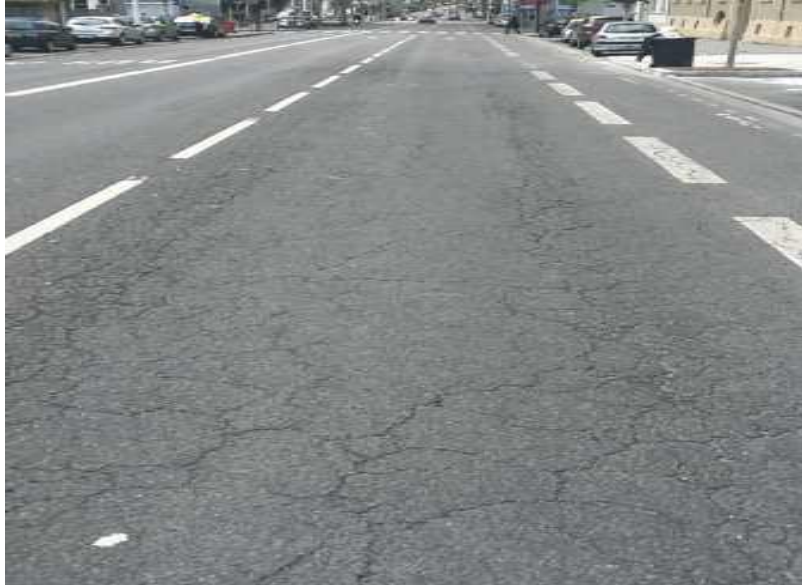
Fig.1-16: Fissuration du revêtement routier par fatigue [25]
