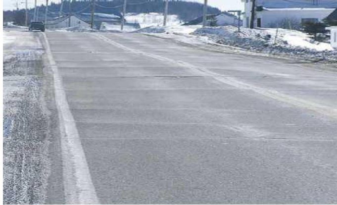
Fig.1.17 : Fissuration par retrait thermique empêché et soulèvement à petites longueurs d'onde.
