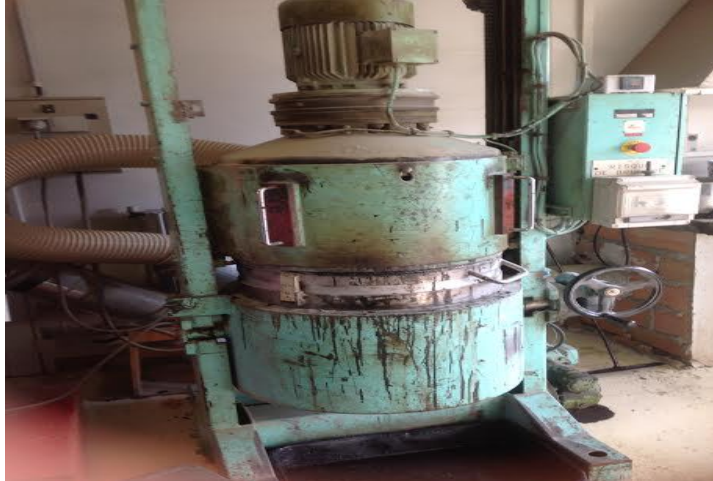
Fig. (4.2) L'appareil de préparation d'enrobé
