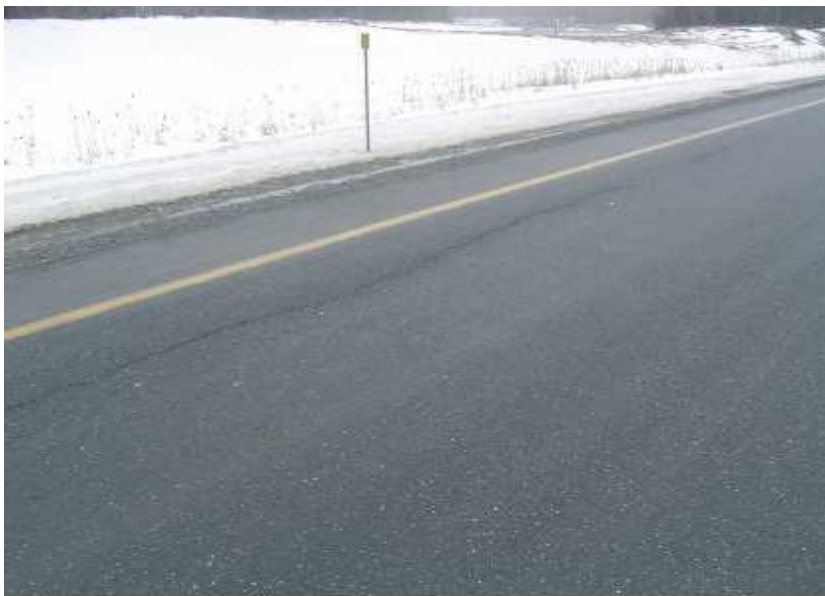
Fig.1.21 : Fissures longitudinale proche de l'accotement de la chaussée (fissure en rive)
