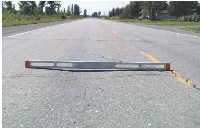
Fig.1.22 : a - Cas d'orniéage structural de sévérité majeure
