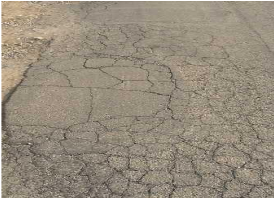
Fig.1.19 : Fissuration par faiënçage du revêtement routier
