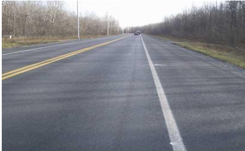
Fig.1.20 : Ségrégation au centre de la table de répandage conduisant à la fissuration de l'enrobé
