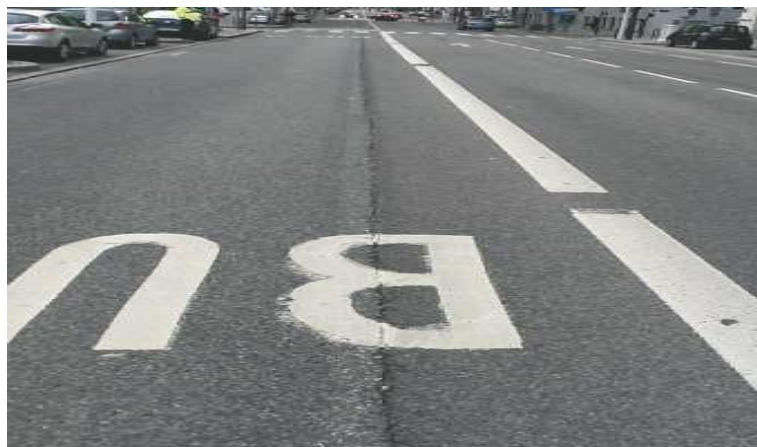
Fig.1.18 : Fissure longitudinale causée par la rupture de joint de construction longitudinal
