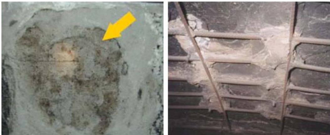
Figure I.24. Ecaillage lors de l'incendie du tunnel mont blanc.
