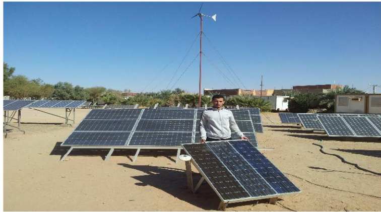
FIGURE 3.11 – Photo de quelques modules PV testés
