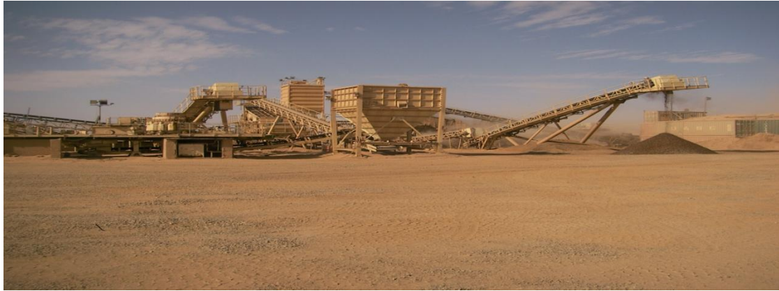
Fig. IV.11: Station de concassage au niveau de la mine d'Amesmesssa
