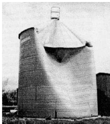
Fig.III.13. Flambement de la paroi cylindrique et du toit conique sous le vent. [20]
