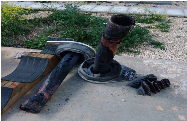
Fig 1.6 : Chambre de coupure du pôle ph0 400 kV complètement détruit [31].
