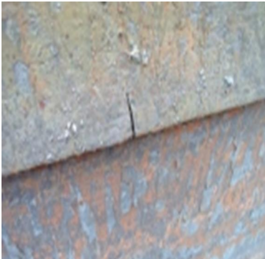
Figure 62 : crique de rive sur les brames (Côté droite)
