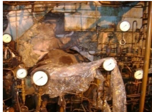
Fig. f : Palier avant turbine N°3
