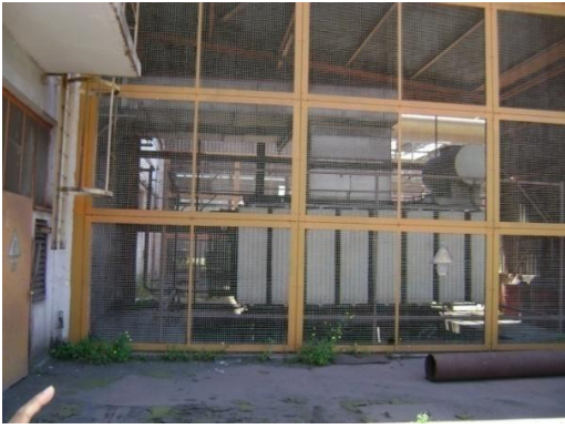
Fig. q: Transformateur
