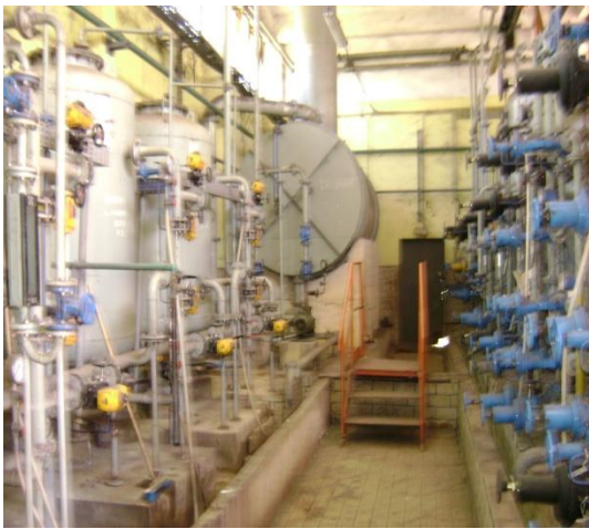
Fig. m : Installation de déminéralisation
