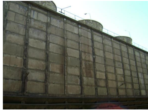
Fig. l : Tour de refroidissement
