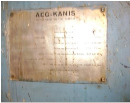
Fig. c : Plaque signalétique de la turbine
