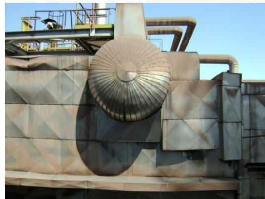
Fig. p : Ballon supérieur (arrière chaudière)
