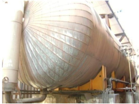
Fig. k : Bâche dégazante
