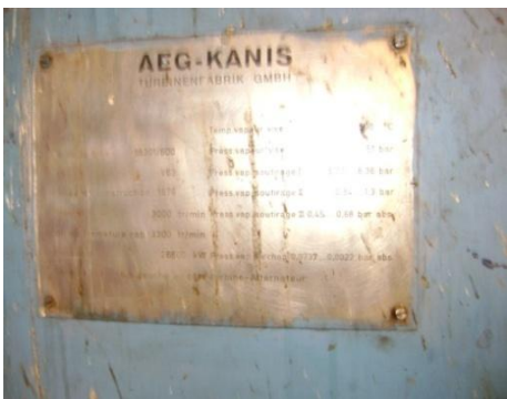
Fig. c : Plaque signalétique de la turbine
