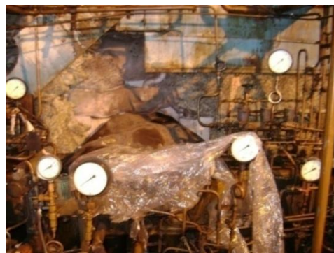
Fig. f : Palier avant turbine N°3
