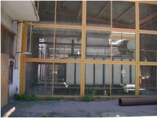
Fig. q: Transformateur
