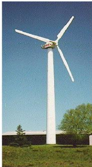
Figure 4.4 – Éolienne type NORDEX N27-150
