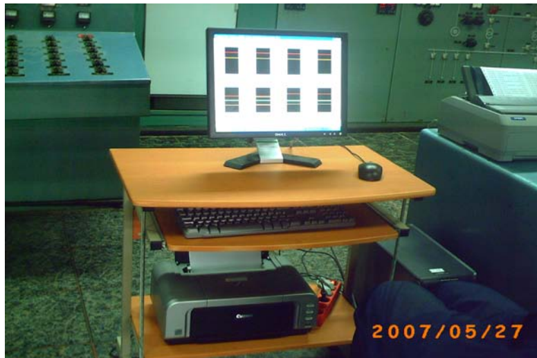
Figure4.41 : Vue générale du poste de contrôle
