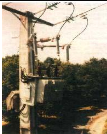
Fig.2.28 Parafoudre HT à oxyde de zinc et enveloppe synthétique protégeant un transformateur MT / BT.
