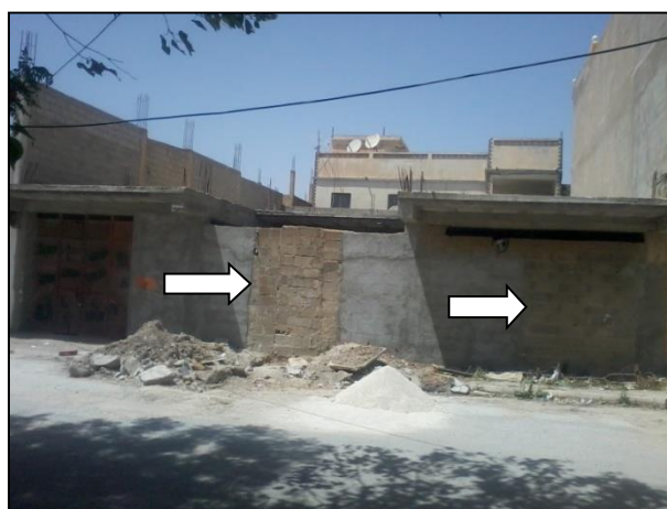
Photo 27, chantier abandonné au lotissement EL AMAL, source : enquête personnelle 2013
