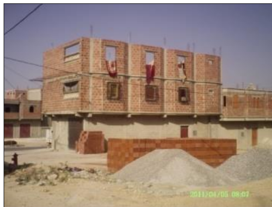
Photo 25, matériaux de construction devenus source de nuisance, au lotissement ENNAHDA, source enquête personnelle 2012
