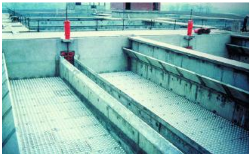
Figure 3.4. Filtres de la station
