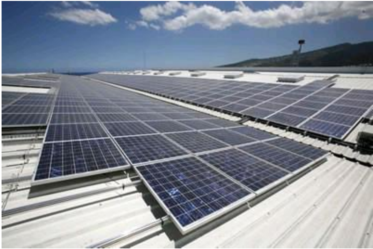
Figure 1.8: Photo d'une centrale solaire
