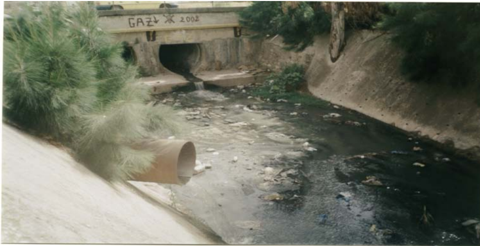
Photo.1 : Rejet des eaux usées au niveau de l'Oued Forcha.
