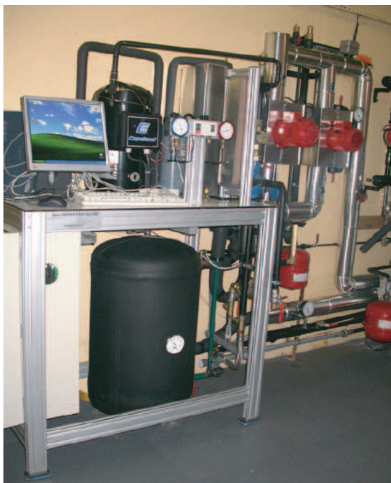
Fig 2.2 – Aperçu réel de l'Installation
