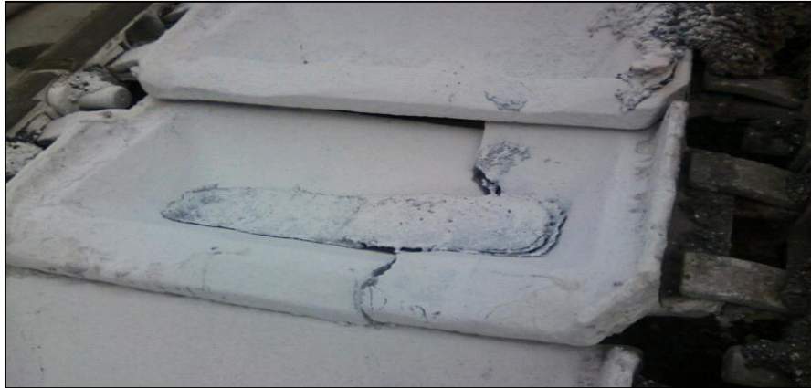
Figure 30. Auget dans un état endommagé.
