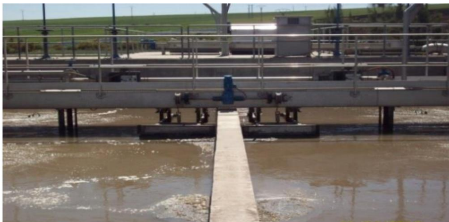
Figure 1 : bassin de dessablage-déshuilage-dégraissage
