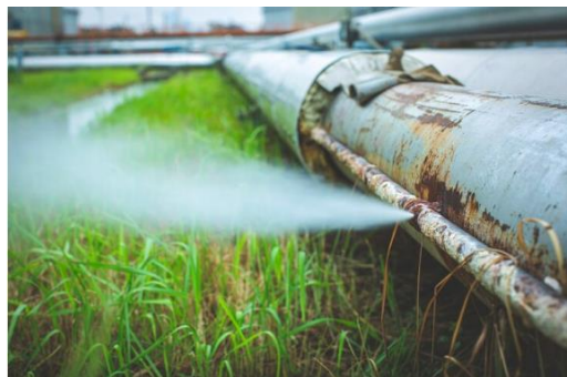
Figure 1.4 : Fuite de gaz survenue dans le pipeline [18]
