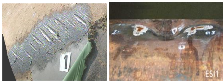
c. pipeline contenant une entaille [14] d. pipeline contenant un enfoncement [14]
