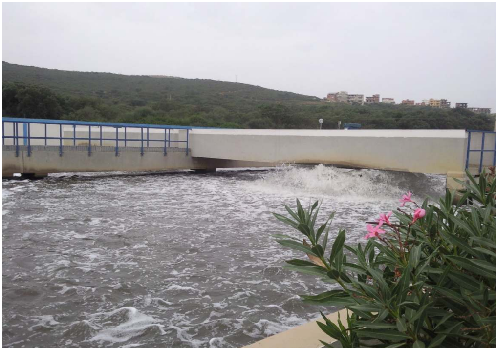
Photographie n°8: Bassin d'aération.
