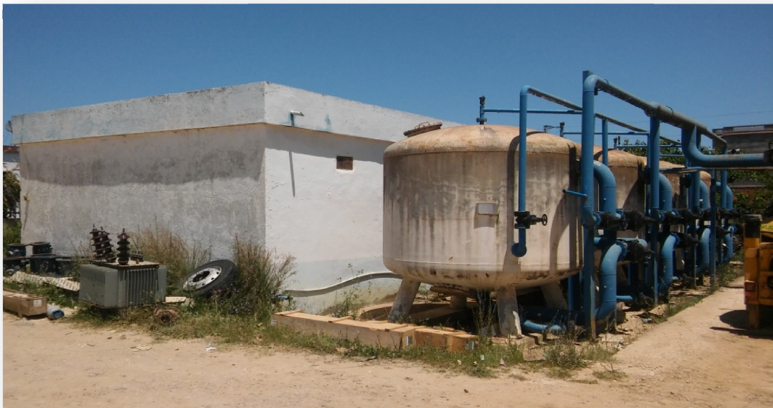
Photographie n°1: Station de relevage BOULIF.
