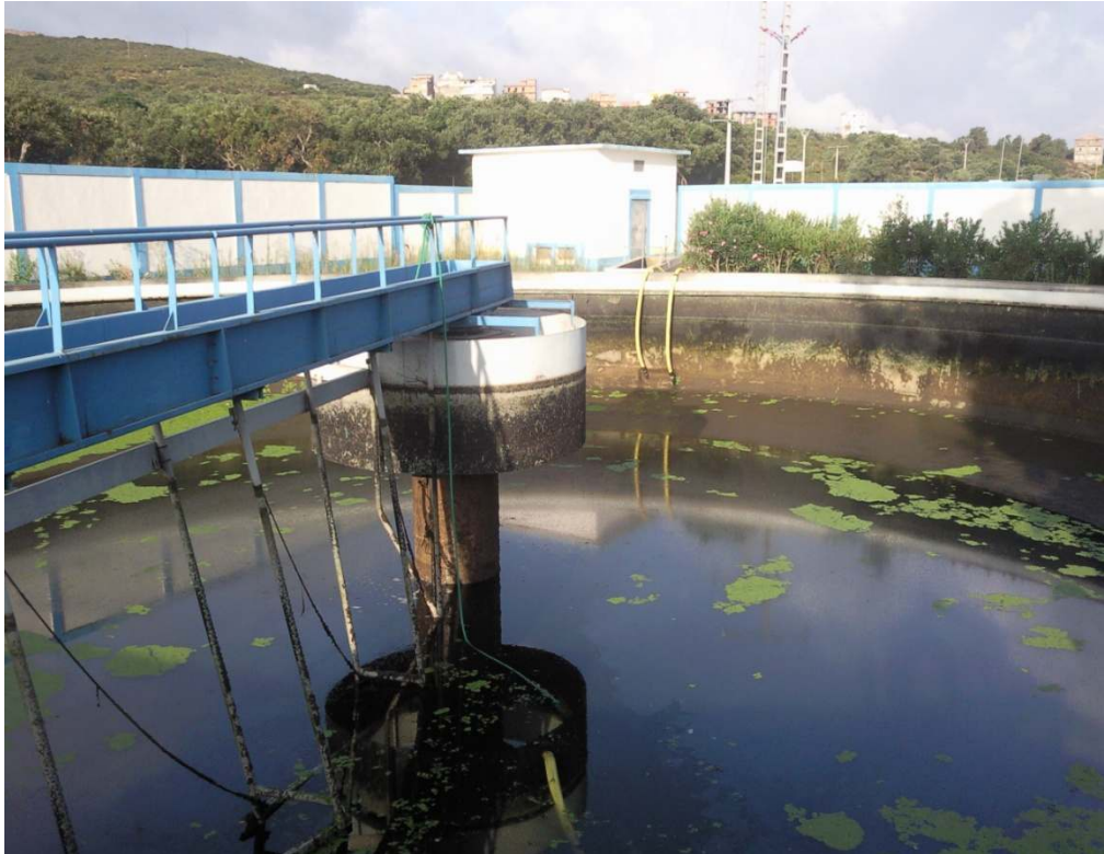
Photographie n°9 : Décanteur.
