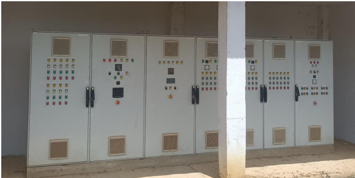
Figure III.20 : Tableaux électrique de contrôle des vannes électrique à distance 2 ème chaîne de production.
