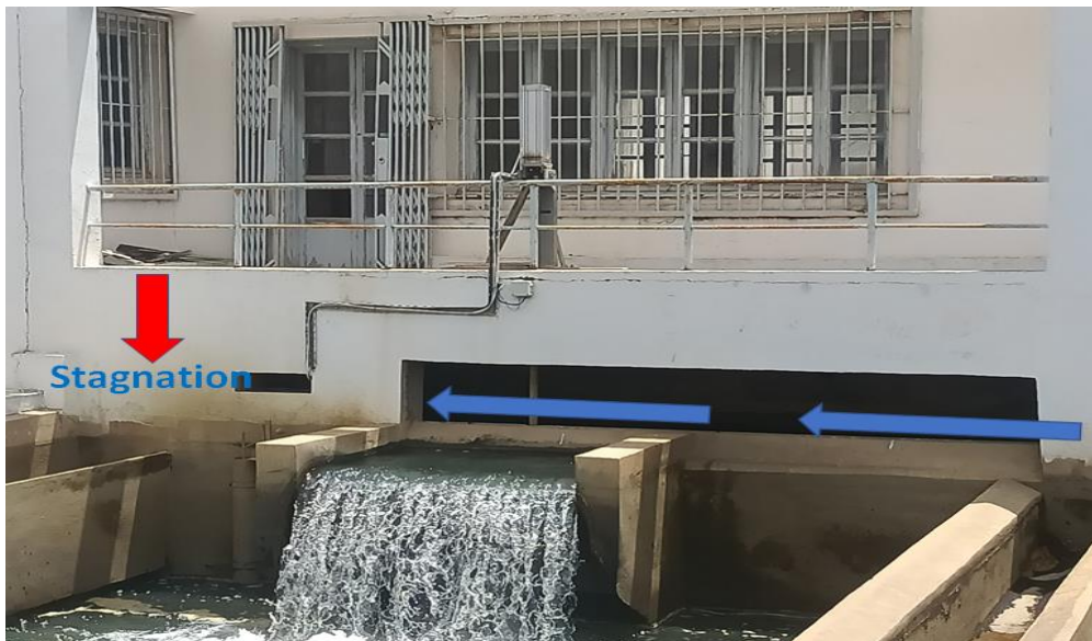
Figure III.18 : Le problème de stagnation dans le dernier filtre de module de filtration 1 er chaine de production.
