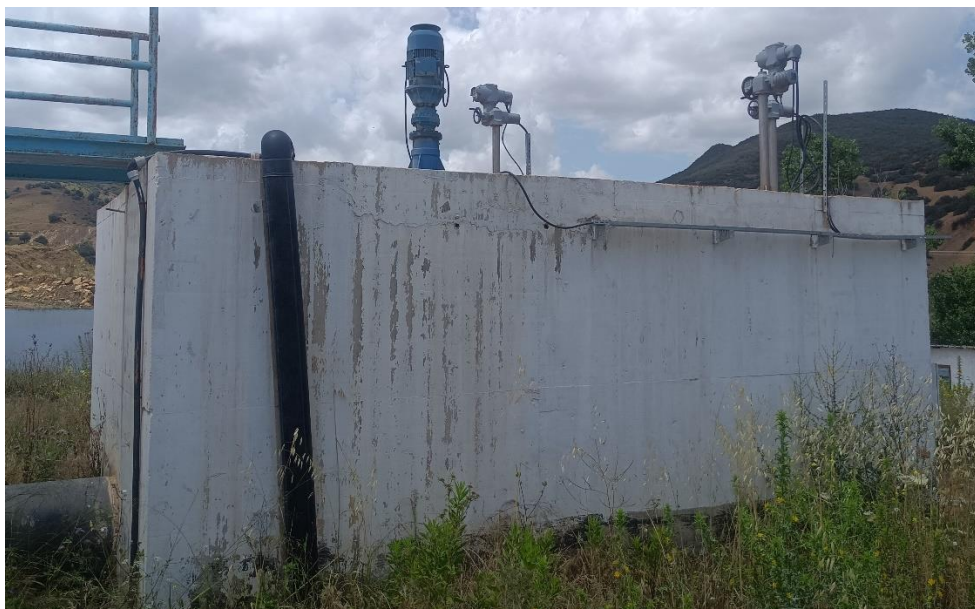
Figure III.6 : Bâche de coagulation 2 ème chaine de production.
