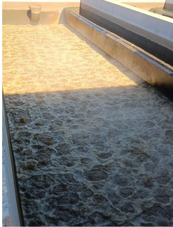
Figure III.14 : Filtres en cours d'opérations de lavage 2 ème chaîne de production.
