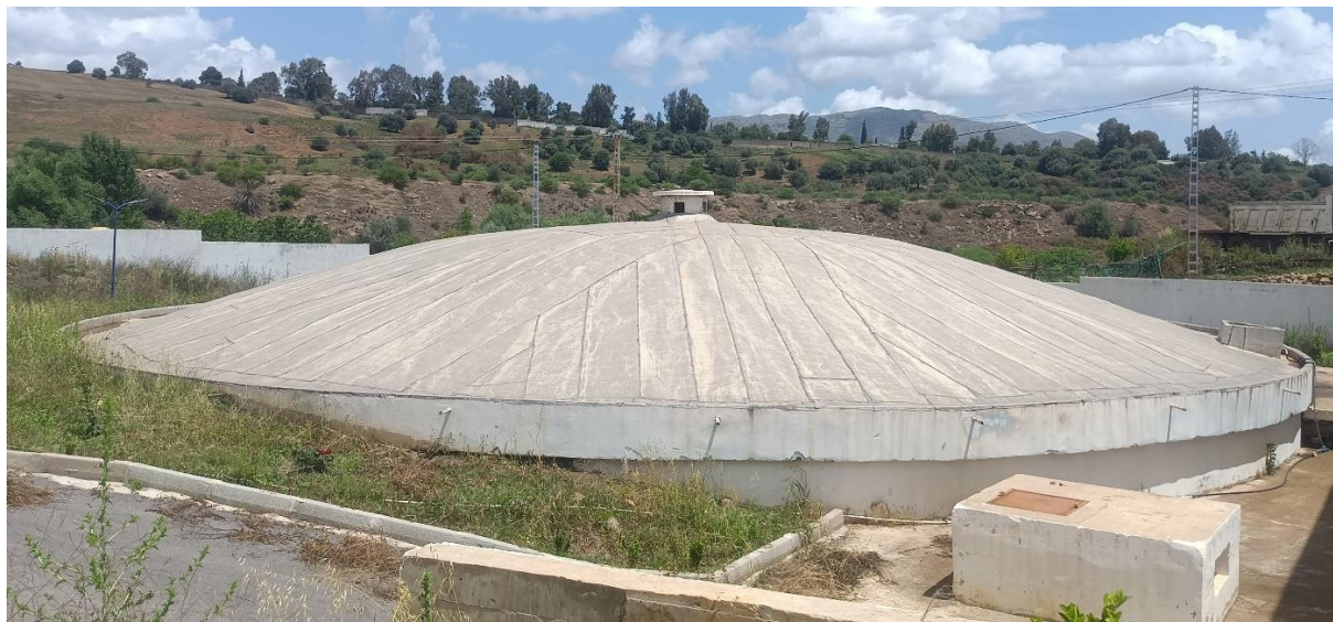
Figure III.16 : Réservoir de stockage 2 ème chaine de production.
