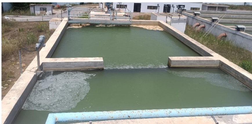
Figure III.5 : Bassin de correction du pH et de pré-chloration 2 ème chaîne de production.
