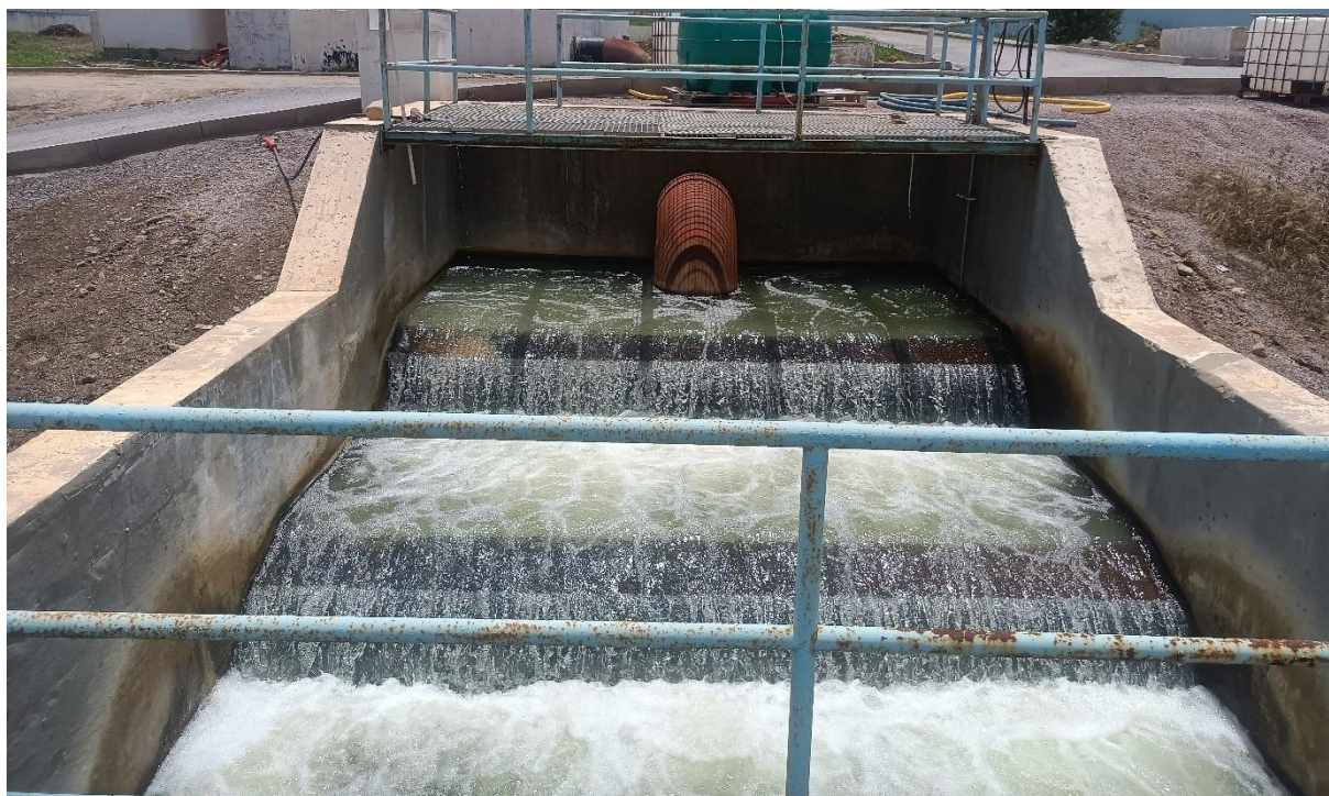
Figure III.4 : Cascades d'aération 2 ème chaîne de production.
