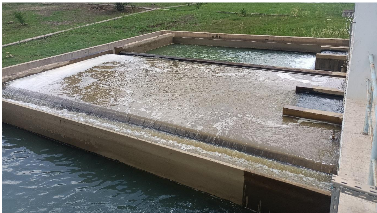
Figure III.12 : Filtres en cours d'opérations de lavage 1 ère chaine de production.
