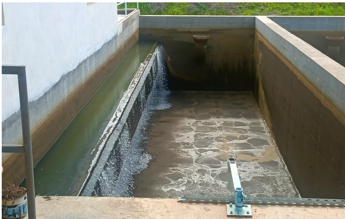
Figure III.13 : Filtre à sable 2 ème chaine de production.
