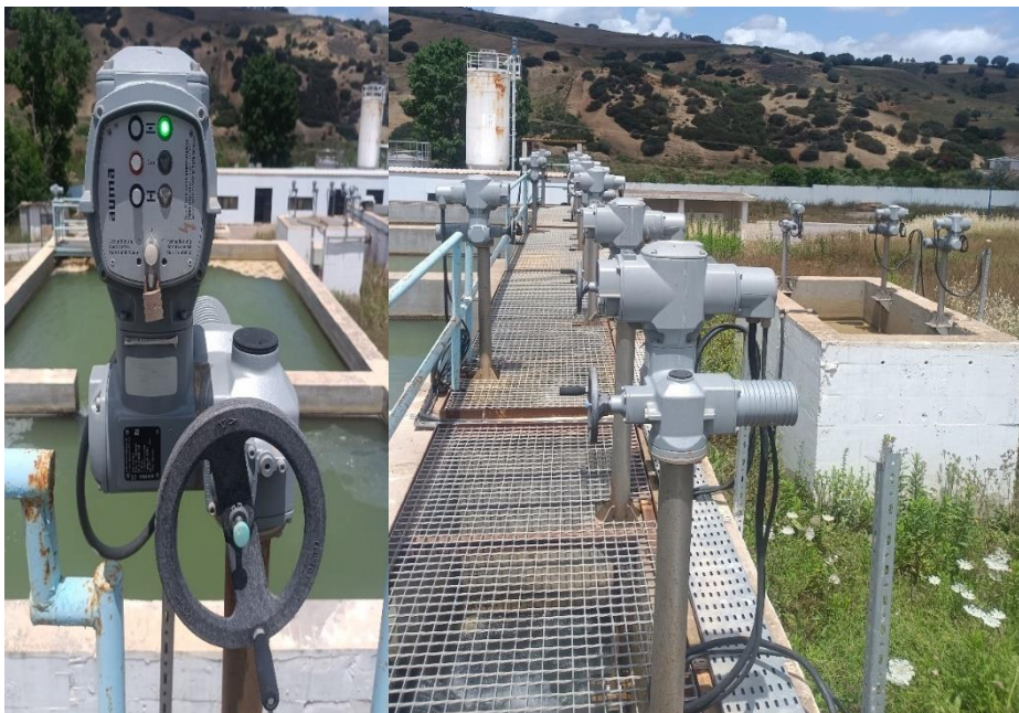
Figure III.19 : Des vannes électriques avec mode local/ distance 2 ème chaine de production.
