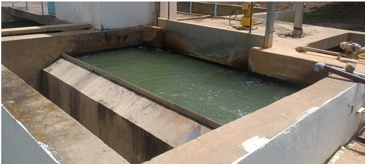
Figure III.1 : Sous bassin de pré-chloration et oxydation 1 ère chaine de production
