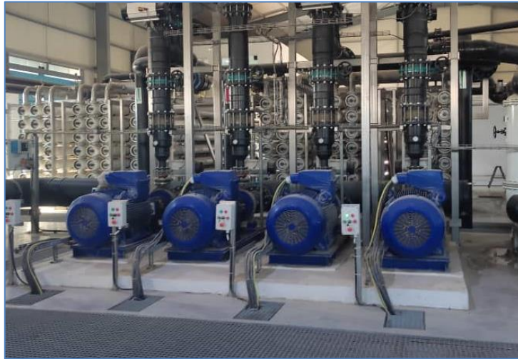
Figure II.13 : Pompes d'alimentation haut pression (HP).
