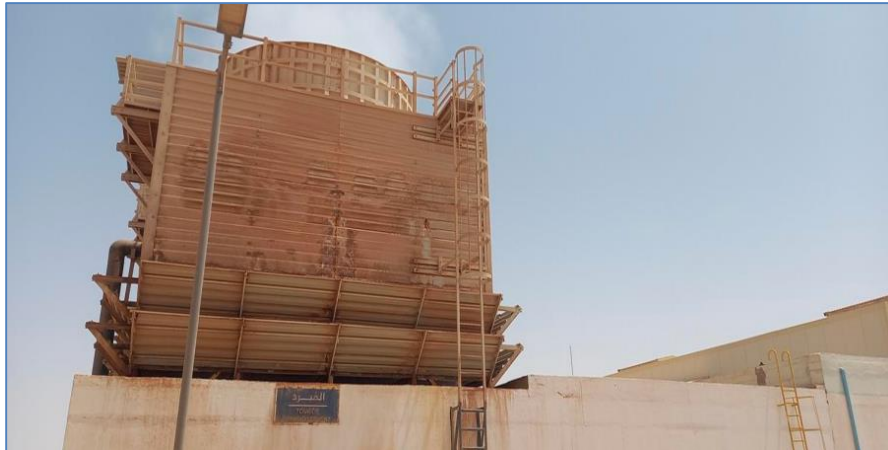
Figure II.6 : Tours de refroidissement.
