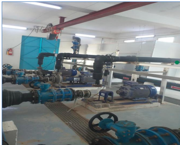
Figure II.17 : pompes de rejet.
