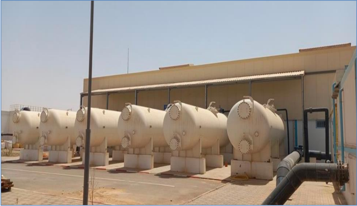
Figure II.7 : Filtres à sable.
