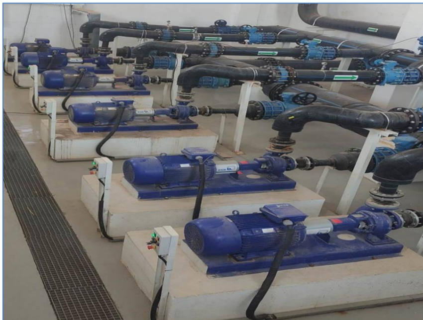
Figure II.15 : Pompes d'eau traitée.
