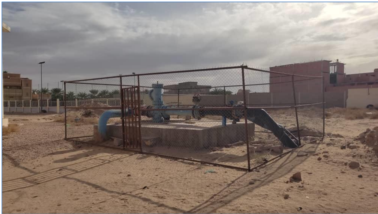
Figure II.4 : Le forage Albien de la station (ELCHOUHADA)
