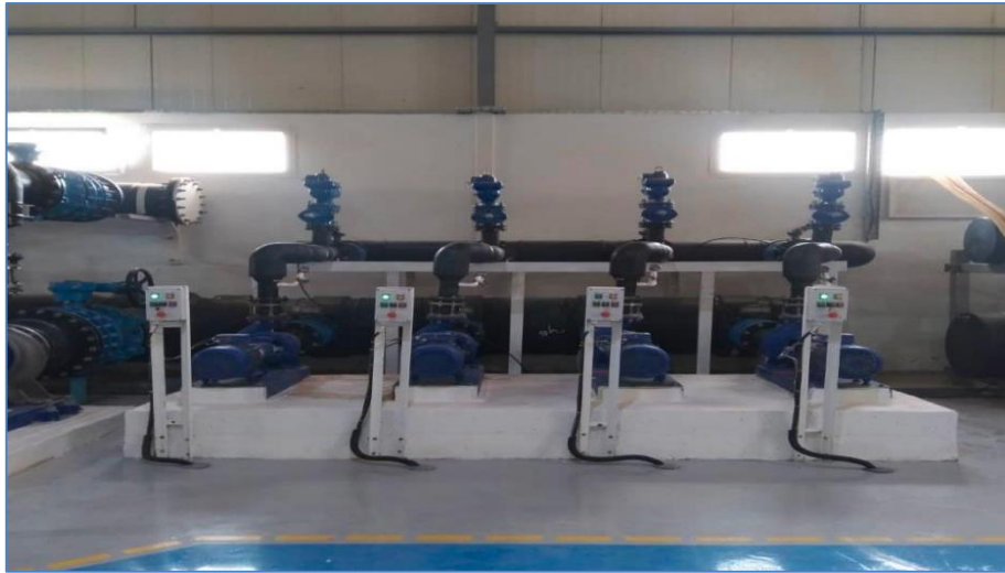
Figure II.9 : Pompes de mélange.
