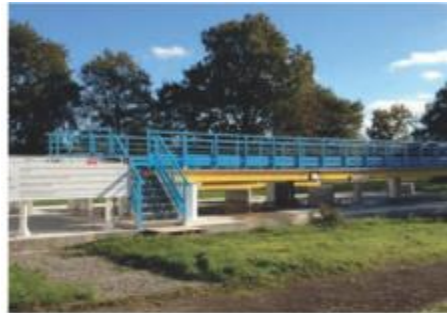
Passerelle équipée de réseaux de Bragg
