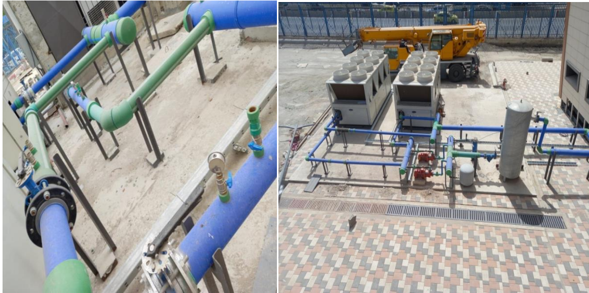
Figure. III.8. Les tuyaux de PPR.
