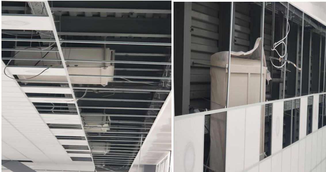
Figure.III.5. Unités de Traitement d'air de la nouvelle gare maritime Annaba.
