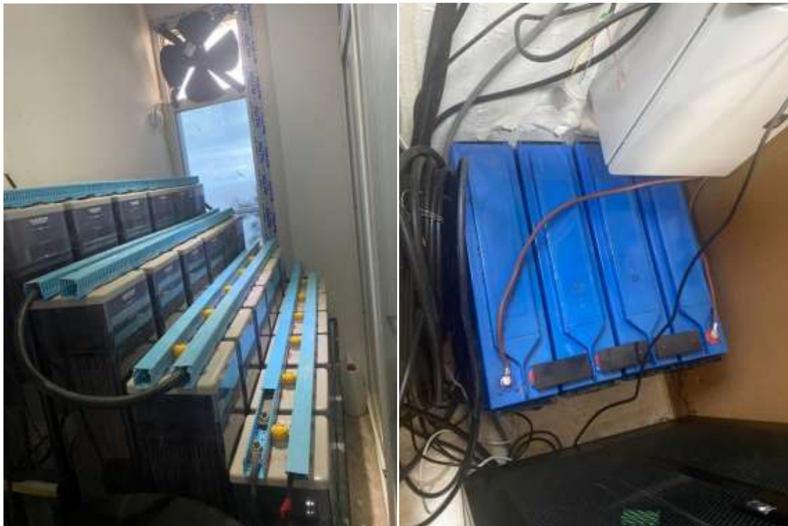
Figure II.10 : Un modèle de batterie acier-Plomb installés au niveau de l'open space
