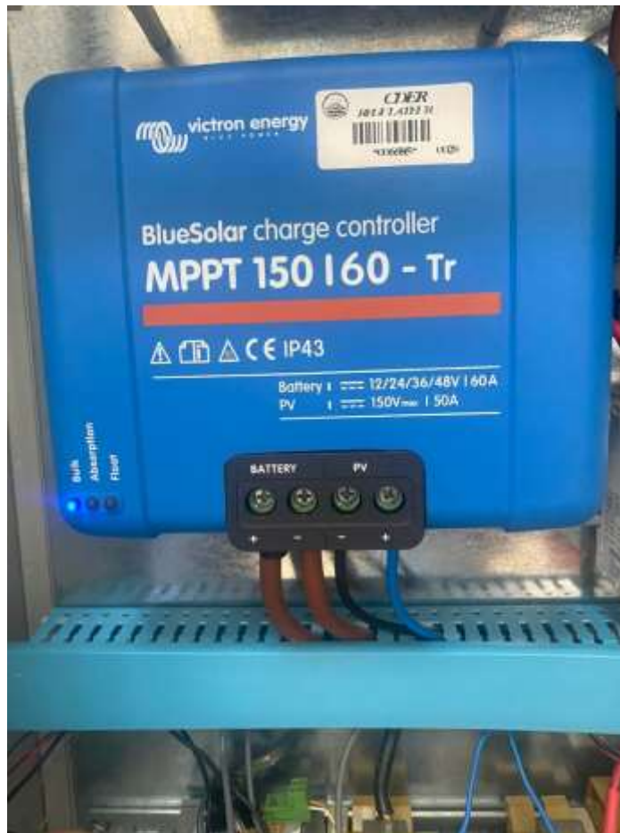
Figure II.7 : Régulateur de charge au niveau de l'open space.
