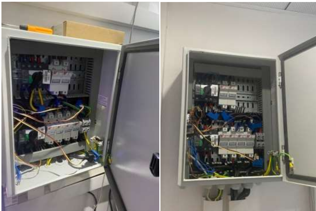
Figure II.14 : Une armoire électrique d'un système PV au niveau de l'open space.
