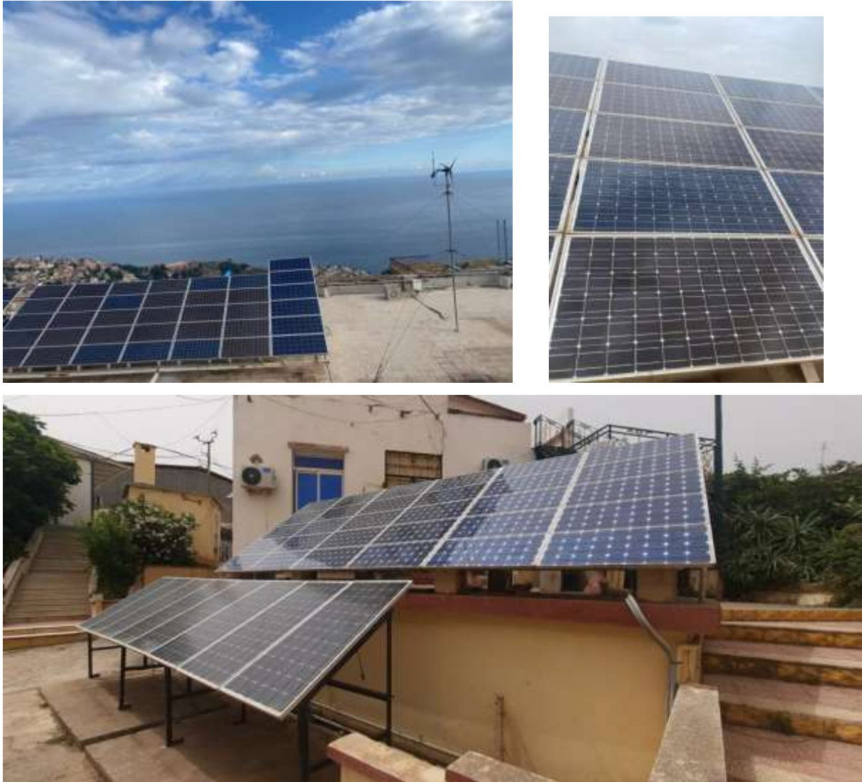
Figure II.3 : Un système de Panneaux solaires Photovoltaïques du CDER
