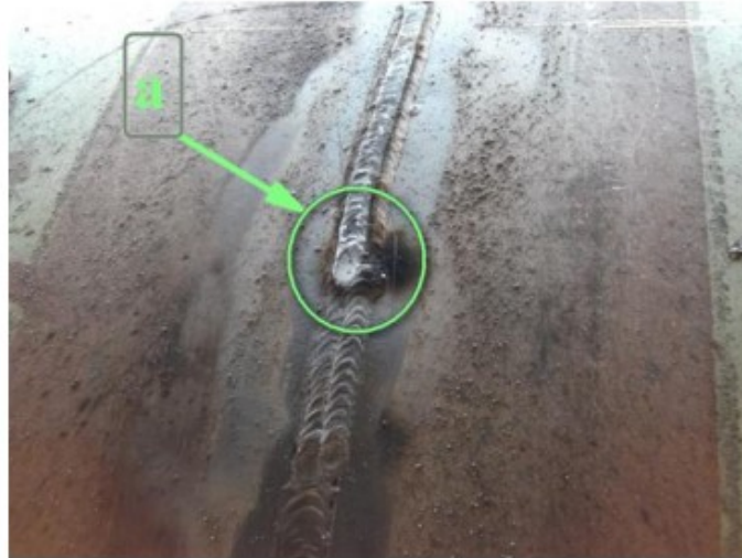
Figure 60 : Cordon de soudure avec les défauts (cratère).
