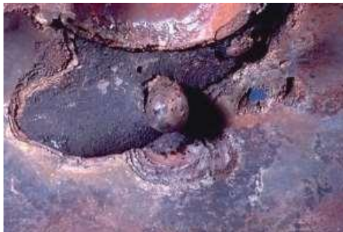
Figure I-20 : La corrosion localisée
