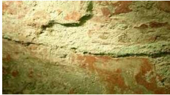
Figure I-23 : La corrosion érosion
