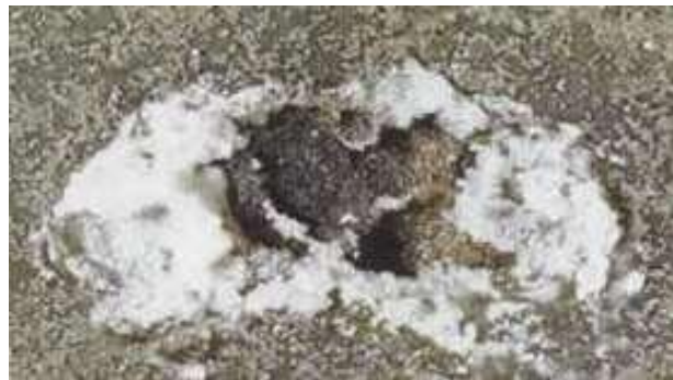
Figure 0-24 : La corrosion par piqûres
