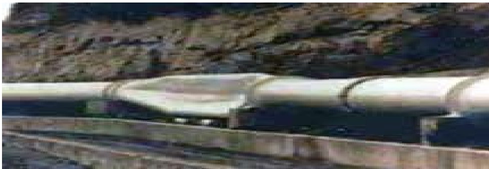
Figure II.4 : élucide une photo d'une conduite aplatie suite à une forte dépression.
