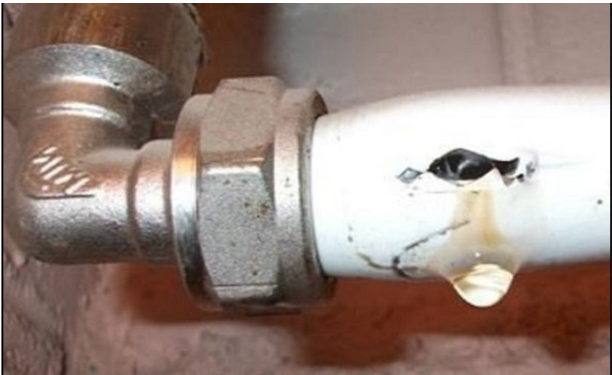
Figure II.3 : Rupture de tuyau en plastique suite à une brusque surpression.
