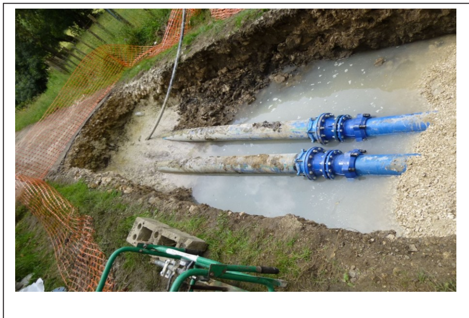
Figure I.1 : Fuites dans une canalisation sur un réseau d'eau potable.
