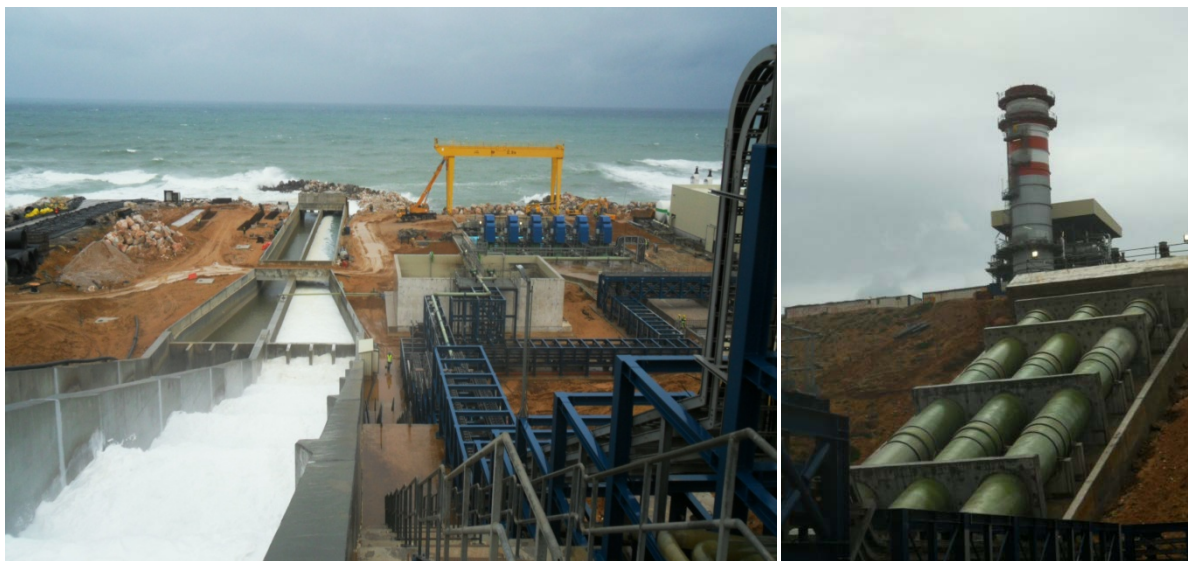
Fig.2.23 Station de pompage d'eau de mer.
