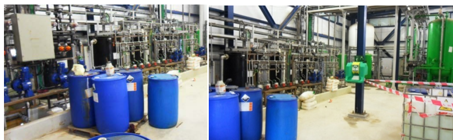
Fig.2.17 Station de déminéralisation.
