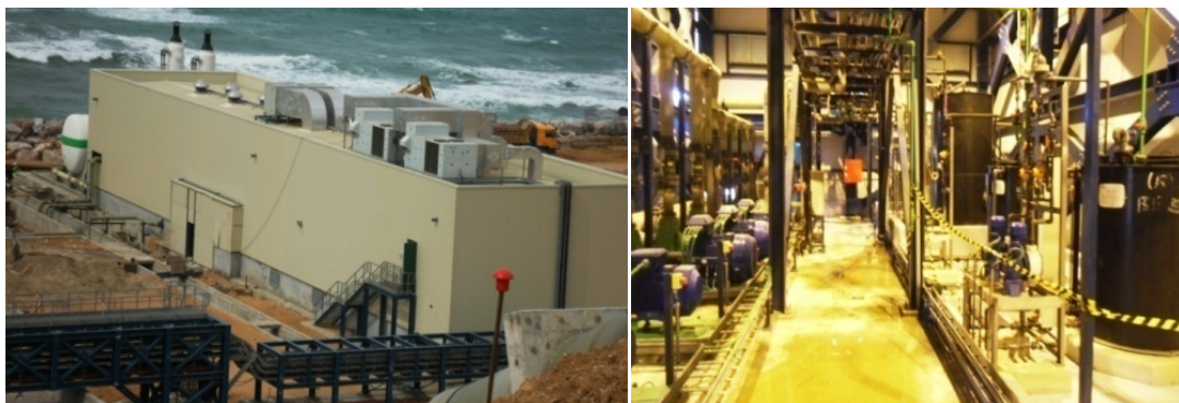
Fig.2.26 Station d'injection de chlore dans la mer.
