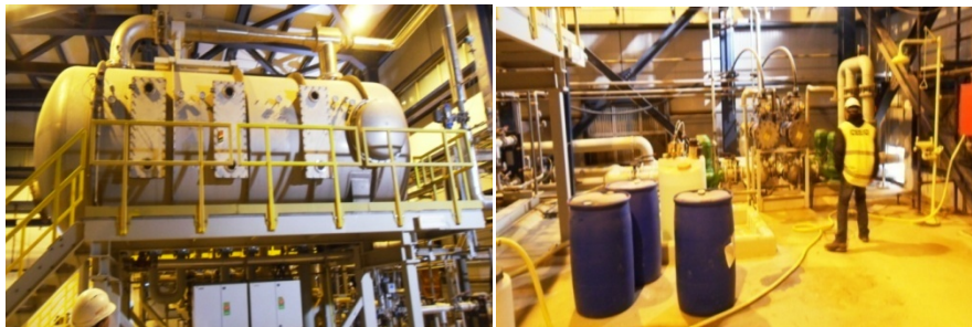
Fig.2.16 Station de dessalement d'eau de mer.
