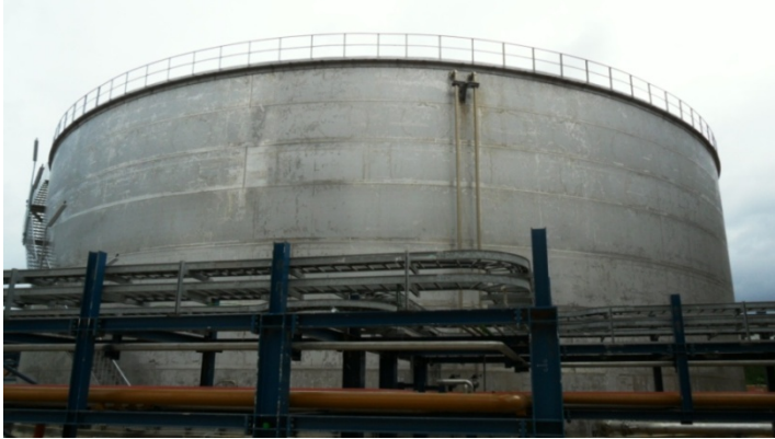
Fig.2.29 Bac d'eaux déminéralisées.
