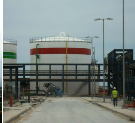
Fig.2.30 Bac d'eau de système PCI.
