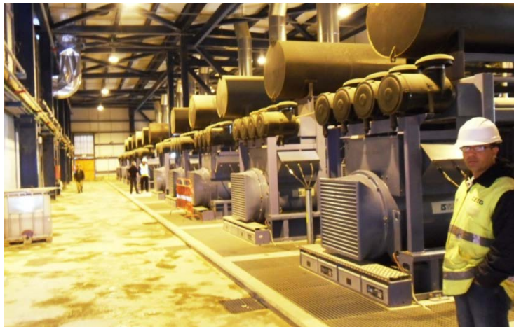
Fig.2.15 Les douze (12) groupes électrogènes de bâtiment BlackStart.
