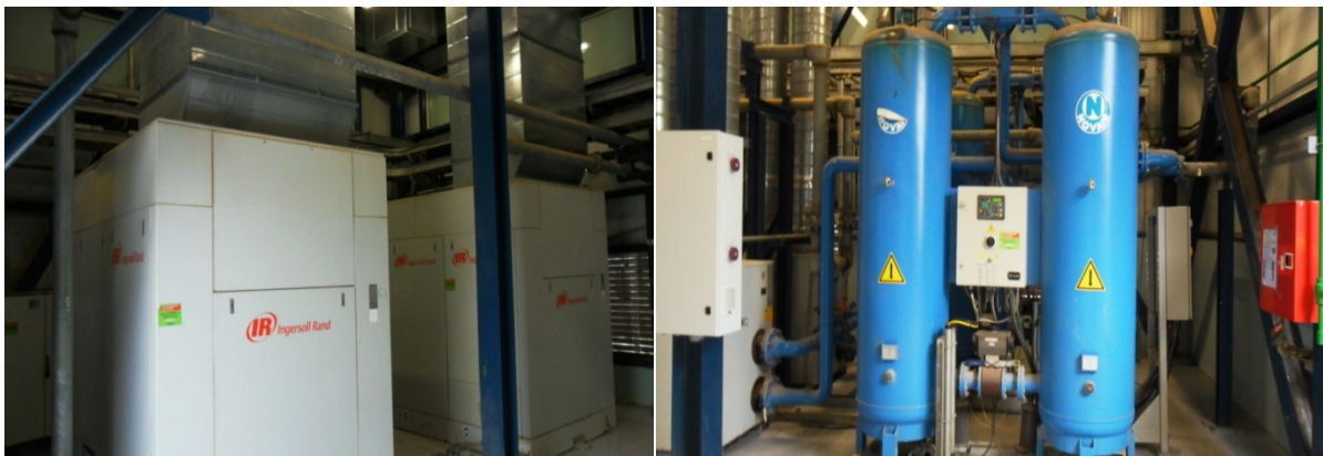
Fig.2.20 Station de production d'air comprimé.
