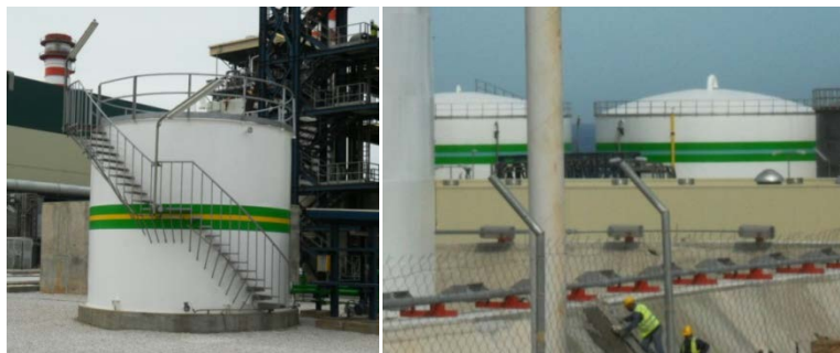
Fig.2.28 Bacs d'eaux dessalées.
