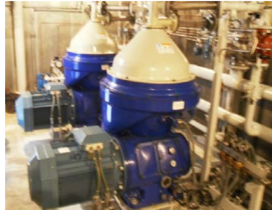
Fig.2.21 Les pompes centrifuges de traitement de gasoil.
